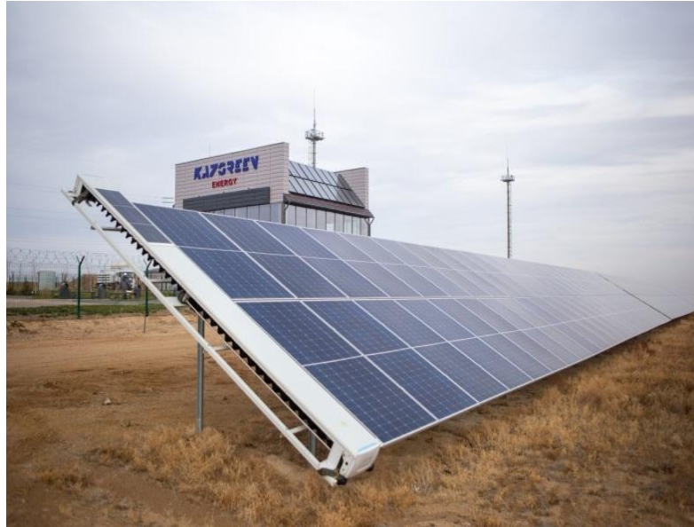
Рисунок 3. Солнечная электрическая станция мощностью 50 МВт в г. Балхаш
